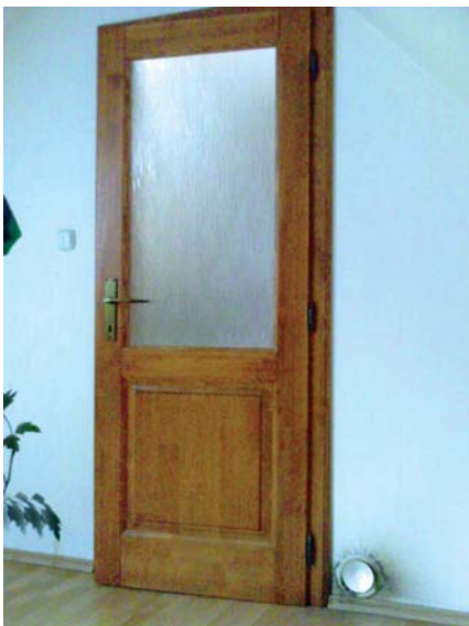
Obr. č. 8 Nevhodne umiestnená teplovzdušná mriežka
