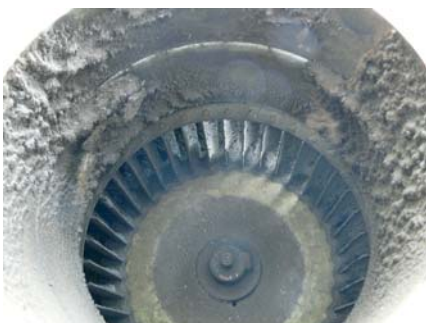
Obr. č. 9 Teplovzdušný ventilátor zanesený prachom
