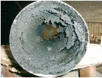
Obr. č. 6 Zanesený dymovod sadzami pri diele krbu, ktorý nebol pravidelne čistený
