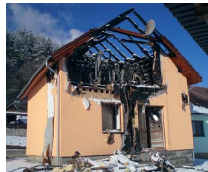
Obr. 1 Nekvalitne zrealizovaný krb a komín spôsobili požiar v novostavbe
