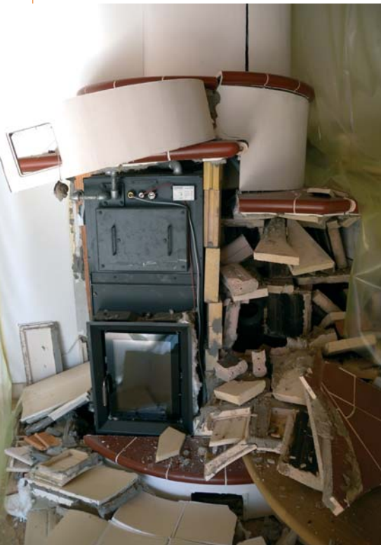
obr. 1 – Kachľová pec s teplovodným systémom bez zabudovania potrebných bezpečnostných prvkov.
